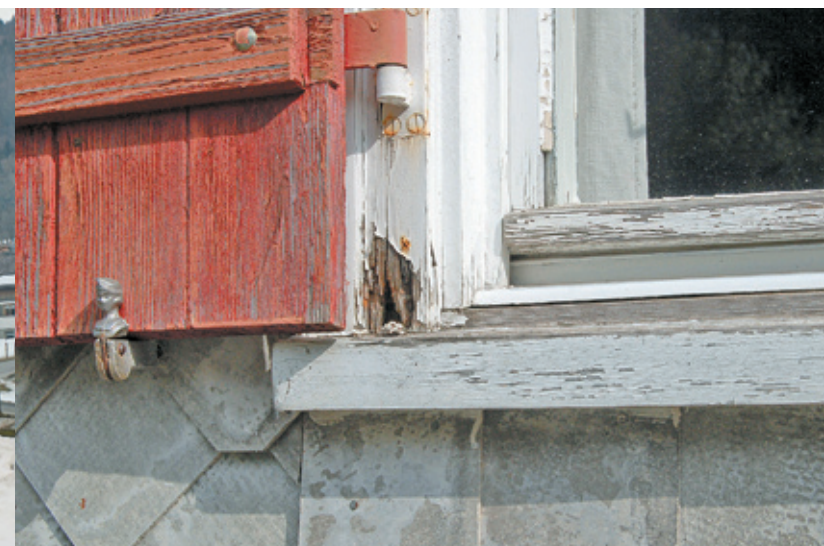
Was in die Jahre kommt, muss saniert werden.
