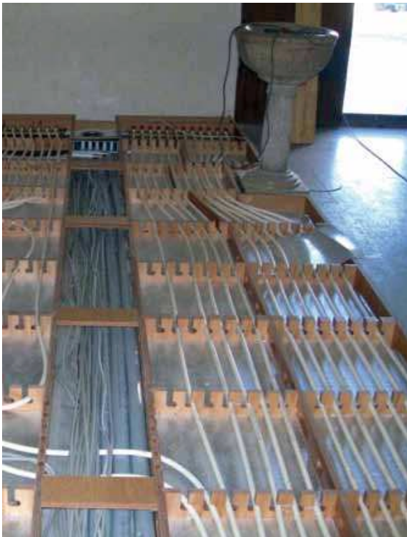
Chiesa di Santa Fosca, impianto riscaldamento a pavimento
