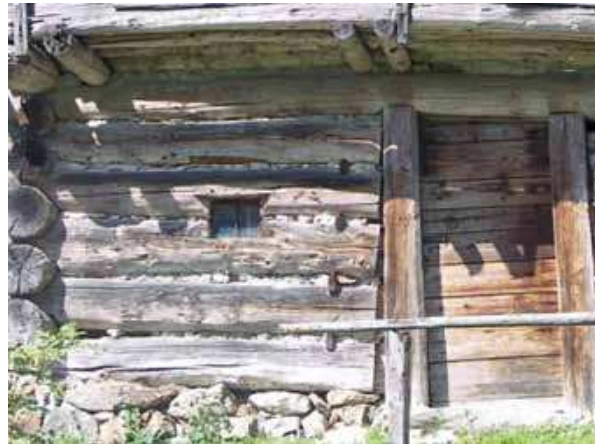
Stalla trentina, Comune di Canal San Bovo (TN) Tratto da "Manuale Tipologico" della Comunità di Primiero
